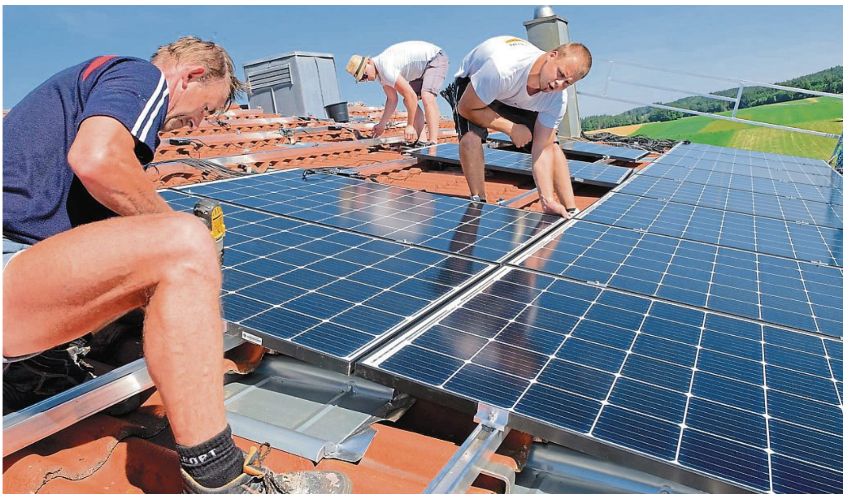
„Bei dem Wetter wirst du von unten und oben durchgebraten“: Fachkräfte montieren auf den Dächern der Firma Soyer Solarmodule. Es wird die größte Dach-Anlage des ganzen Landkreises werden.
